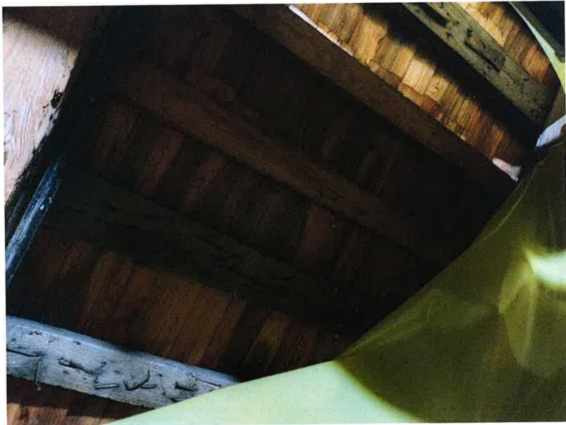
FOT. 2 Widok na skorodowany gont od strony poddasza
