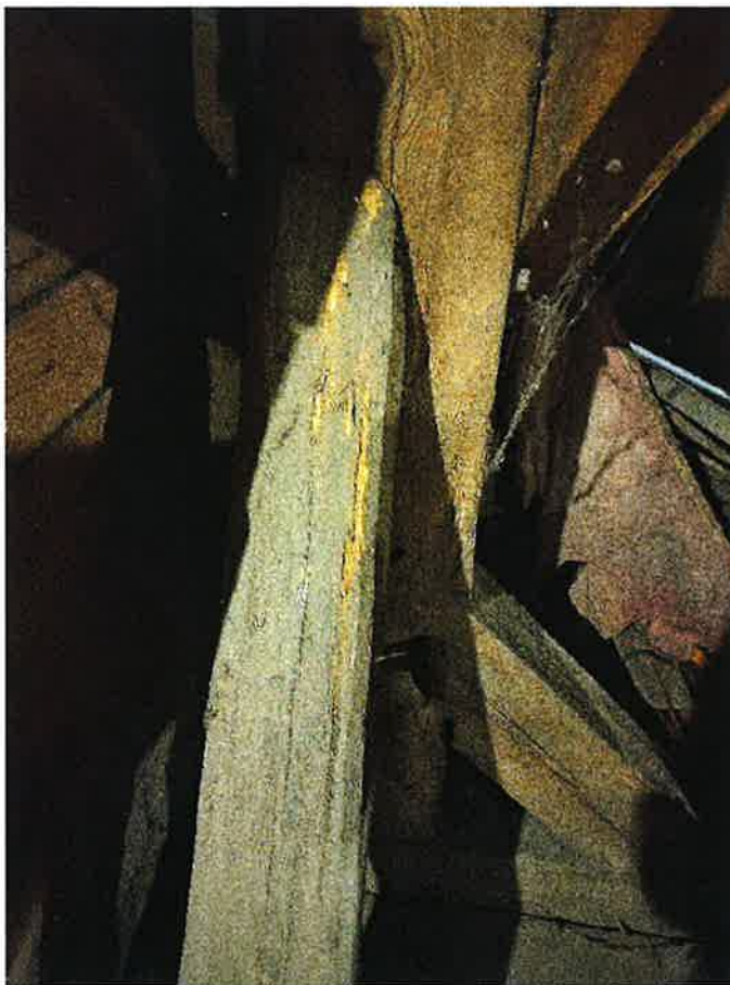
FOT. 4. Widok na spróchniałe elementy więźby
